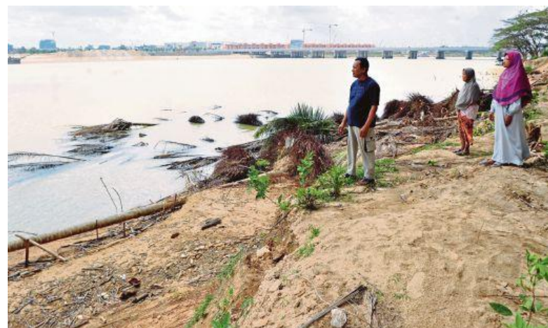
Foto 2.4: Keadaan tebing Sg. Kelantan berhampiran Kg. Pasir Pekan Tengah yang terhakis kesan daripada kejadian banjir
