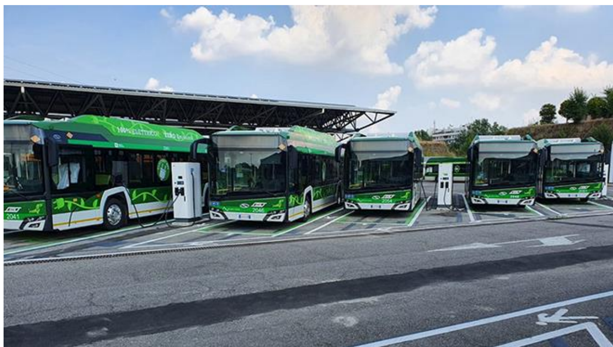
Foto 4: Petak Pengecasan Bas Elektrik
