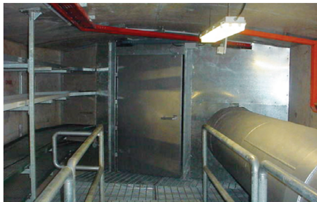
Foto 12: 'Compartment Barrier Wall Panel' yang memisahkan terowong utiliti yang panjang kepada bahagian-bahagian bagi memudahkan kawalan dan keselamatan.
