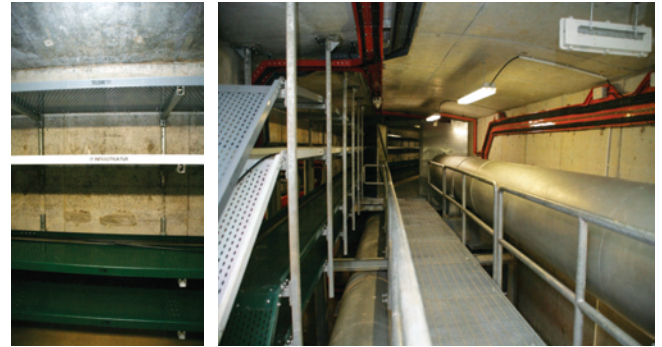
Foto 16: Susunan bagi paip air dan rak komunikasi yang sesuai ditempatkan di dalam galeri yang sama
