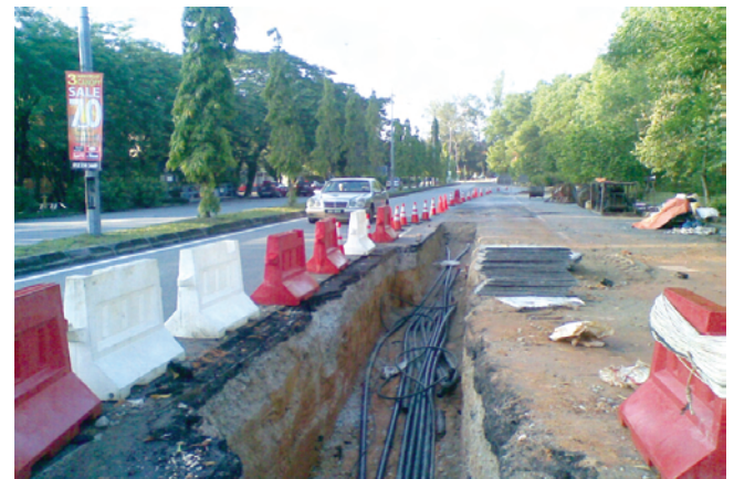
Foto 1: Korekan atas turapan jalan kerana kerja-kerja pembaikan laluan utiliti mewujudkan gangguan terhadap aliran trafik, kualiti visual dan keselesaan penduduk.
