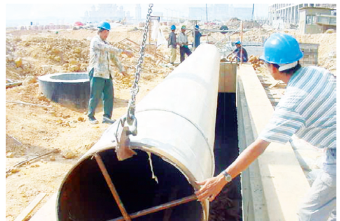
Foto 14: Laluan pembinaan yang disediakan untuk memasukkan peralatan dan bahan binaan yang besar ke dalam terowong tanpa memerlukan kerja korekan.
