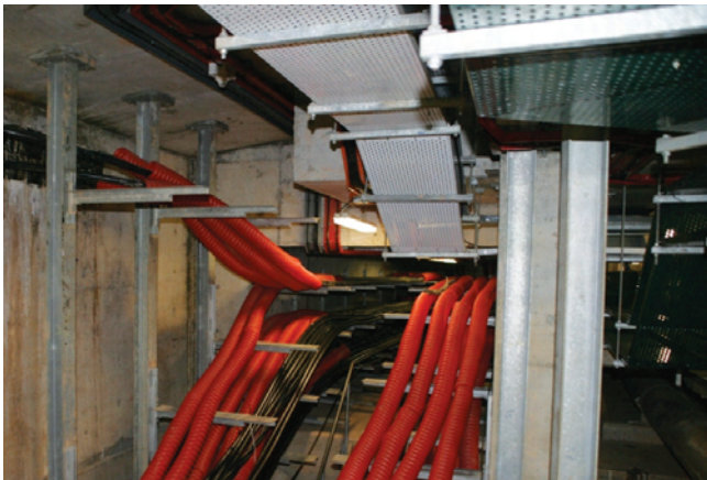
Foto 15: Kabel elektrik ditempatkan di dalam galeri yang berasingan.
