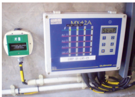
(d) Panel Pemantau Gas & Door Break Glass
