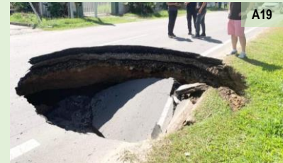
Lubang benam yang berlaku di Jalan Teluk Likas, Sabah.
